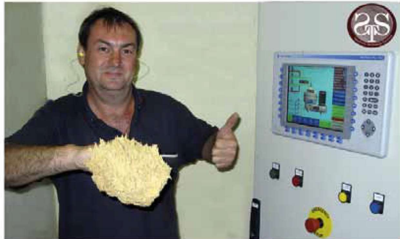
Sistema de Control del Operador en Distell Group - Bergkelder, Stellenbosch, Africa del Sur
