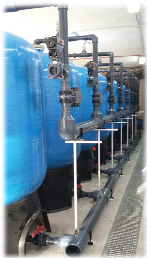
Montaje filtración submicrónica para equipo de osmosis inversa reversible.
