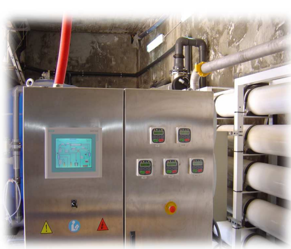
Control electrónico local y remoto de un equipo desalinizador instalado en un hotel . Ibiza. Producción: 525 m³/día .
