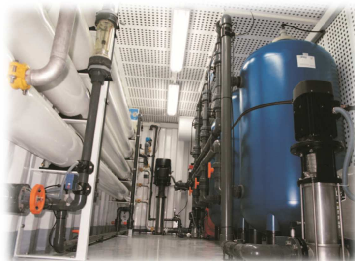
Equipo de osmosis inversa instalado en container insonorizado en un hotel . Grecia. Producción: 300 m³/día
