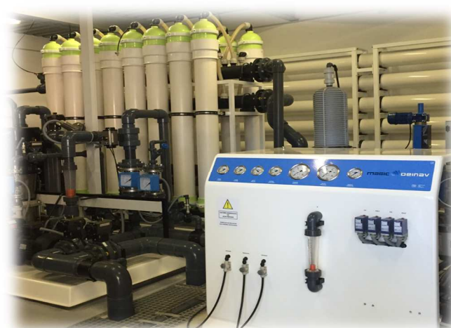
Equipo de osmosis inversa instalado en campo de golf.
