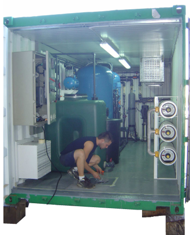
Equipo de osmosis de agua salobre instalado en container.
